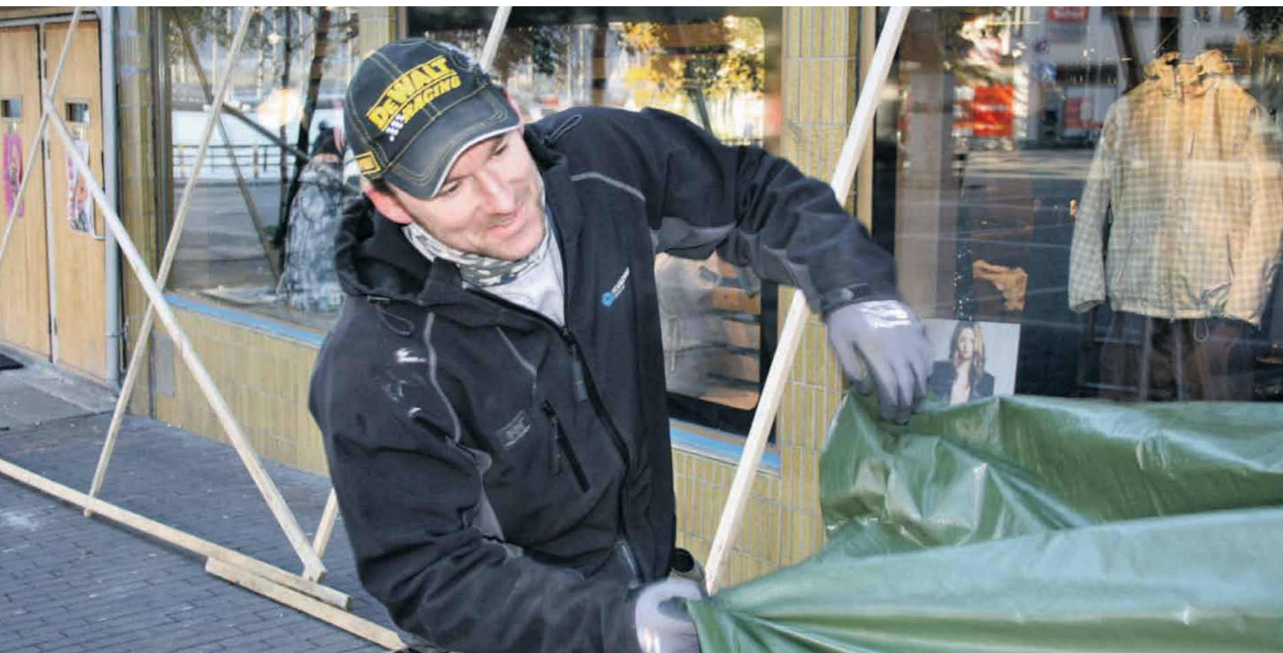
Vidar Bakken, tømrer i Kvadro bygg, starter arbeidsdagen med å brette ut presenning utenfor Gerhard Holthe-bygget.
