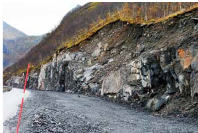
Fanggrøfta ved vegen opp Torskenskarret skal ta imot stein- og snøras.
