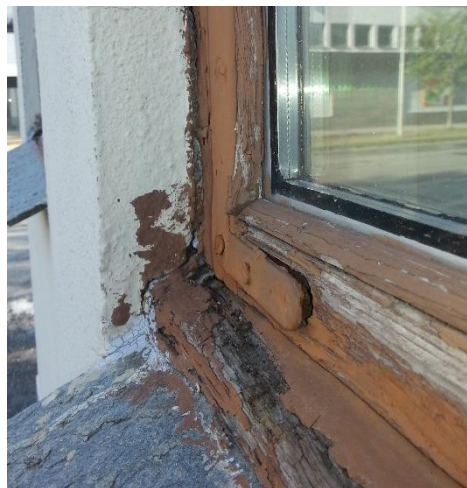
Bilde 2: Rådhuset, TG 3(tilstandsgrad)
