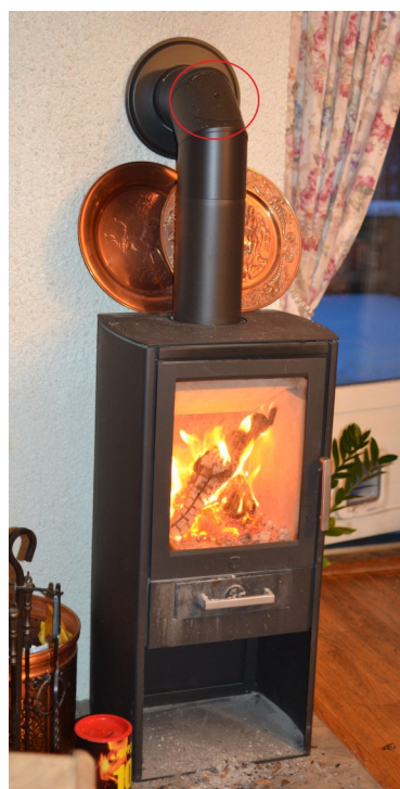
Rød sirkel viser luke som tas av for å feie røykrøret.
