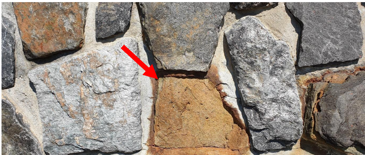
Figur 3 Murvegg med innlagte stein som viser varierende forvitring og syredanningseffekt på betong. Tydelige tegn på syredannelse fra stein markert ved rød pil blir ofte først åpenbart når steinen har hatt tid til å forvitte. Foto: Ånund Ettestad
