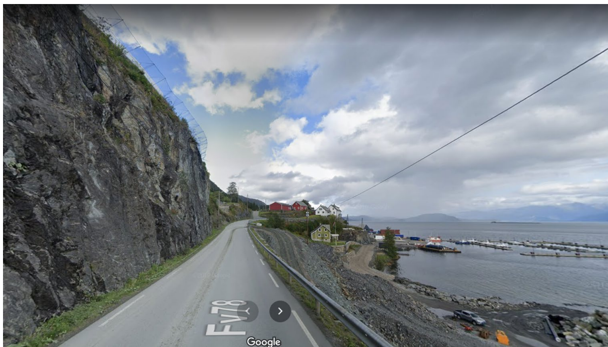
Figur 7 Fjellskjæring langs Fv78; Sikring med nett i toppen av skrent (fra Google Street view)
