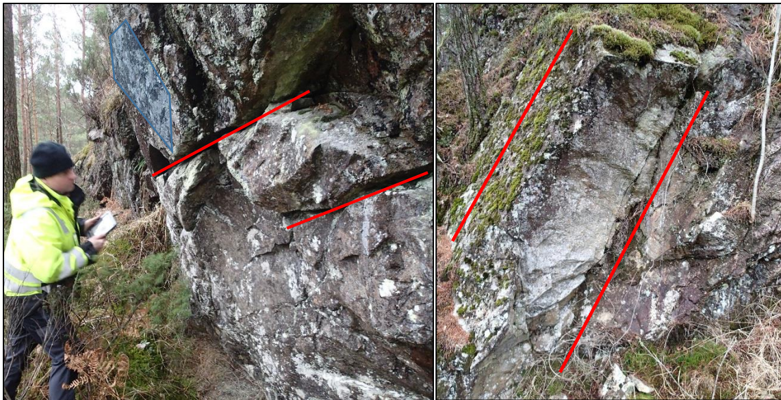
Figur 13: Gabbro med markerte sprekkeplan, med fall ut av planlagt skjæring ved PEL 8460. To markerte sprekkeplan med fall ut av planlagt skjæring er markert med rødt, disse kan gjenkjennes fra figur 12, en tredje avgrensende planflate er markert med blått.
